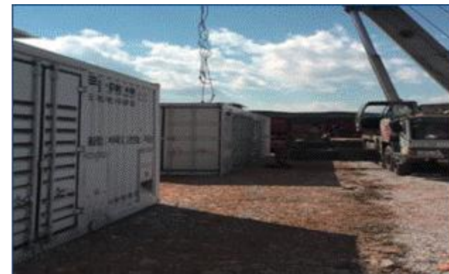
35kV/4MVA新能源测试平台
